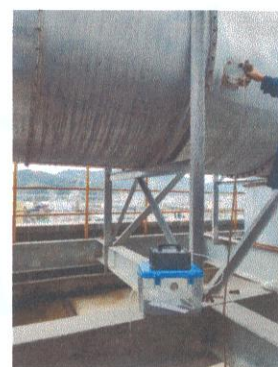
研发室排气筒出口 03#
