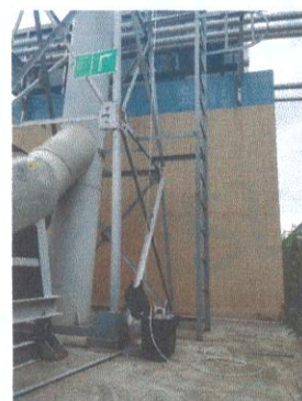
RTO 排气筒出口 06#
